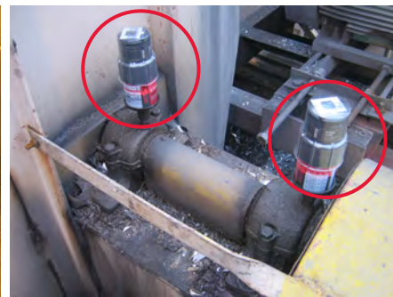
Lubricación de los cojinetes del eje del ventilador
