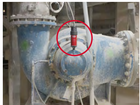
Lubricación del cojinete de una bomba
