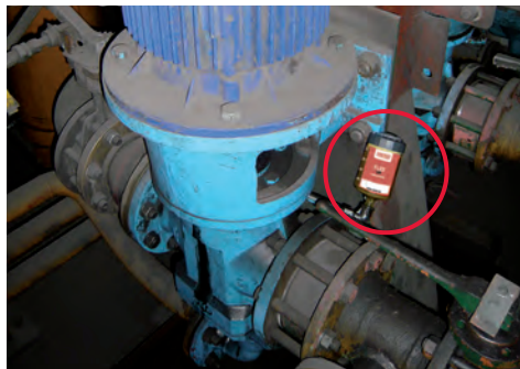
Lubricación de una bomba de combustible en el proceso de refinado
