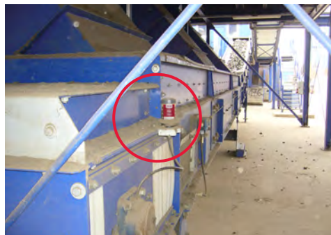
Lubricación del cojinete de brida de una cinta transportadora
