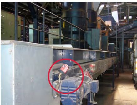
Lubricación del cojinete de brida de una cinta transportadora
