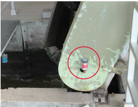
Lubricación de rodamientos en el cribado grueso
